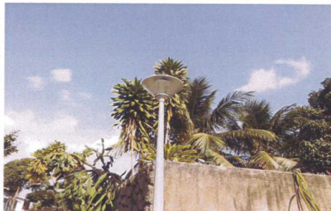
POSTE DE ILUMINAÇÃO
