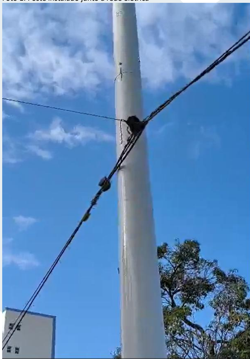
Foto 1: Poste instalado junto a rede elétrica
