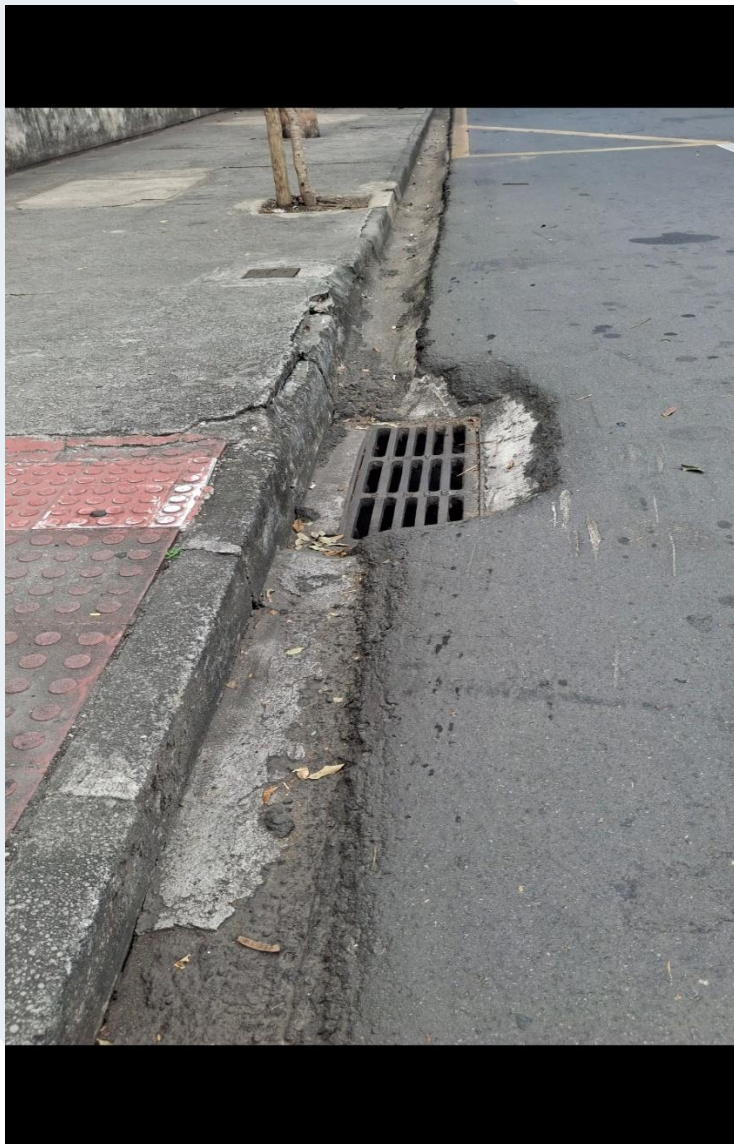
Foto 1: Boca de lobo desnivelada.
