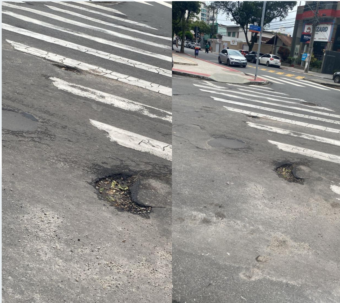
Foto 1: Buracos devido a desgastes asfáltico.
