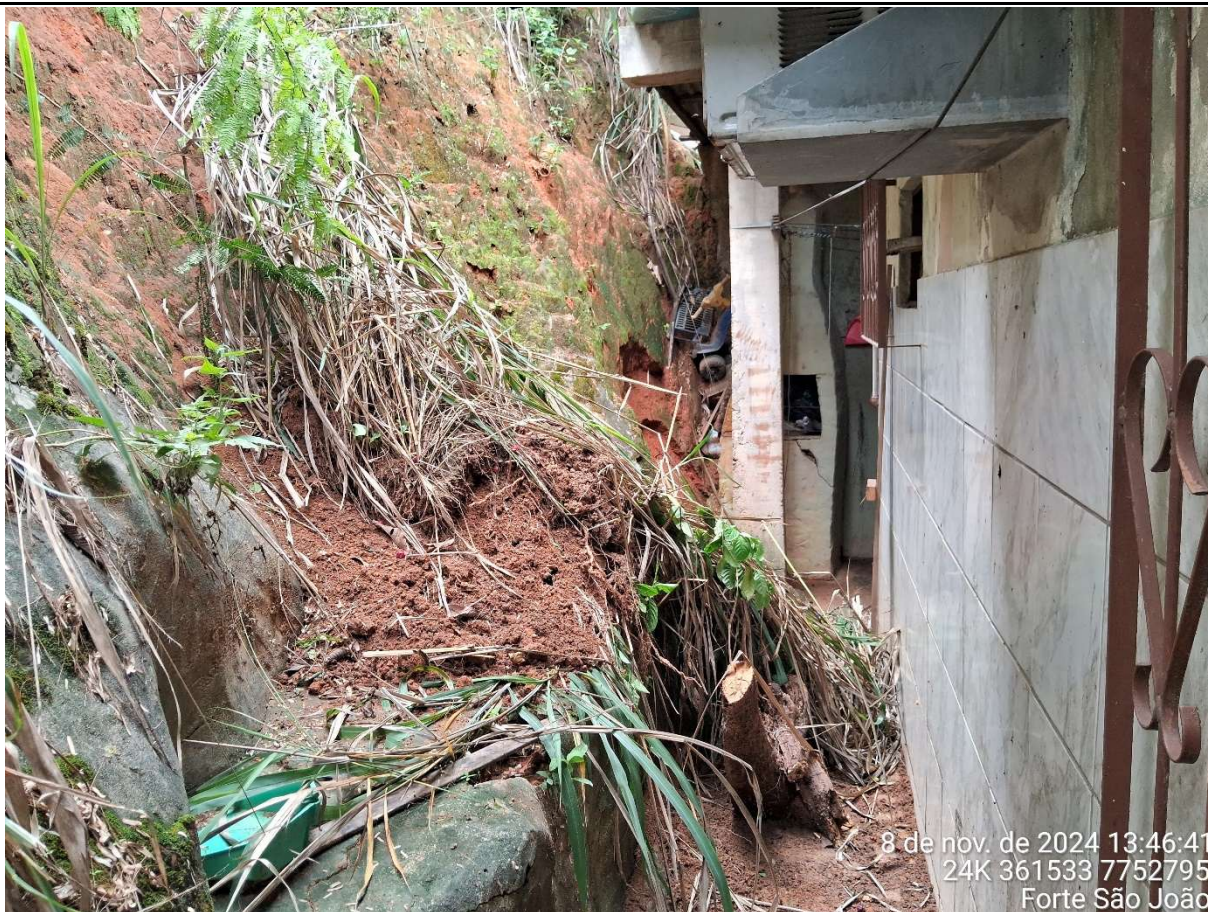
Imagem 16. Imagem do relatório 773/2024, mostrando deslizamento de terra que atingiu a área de serviço do imóvel da Sra. Camila Borges.
