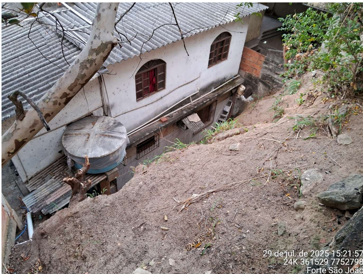
Imagem 5. Vista por outro ângulo do talude e fundos do imóvel na cota inferior.
