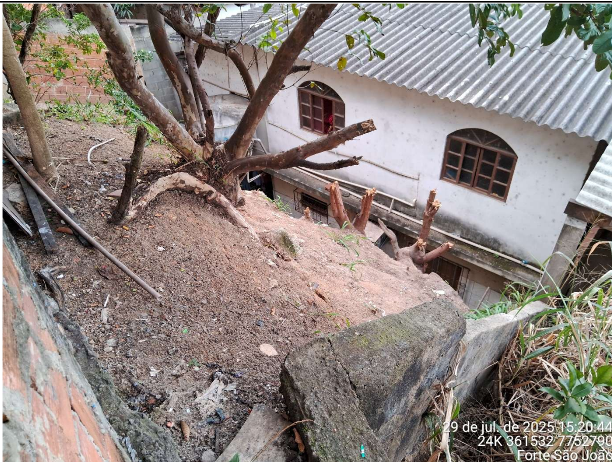
Imagem 4. Vista do talude e fundos do imóvel da Sra. Camila Borges na cota inferior.
