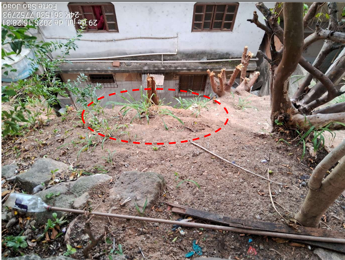
Imagem 8. Pequenos degraus de abatimento na crista do talude (no detalhe).
