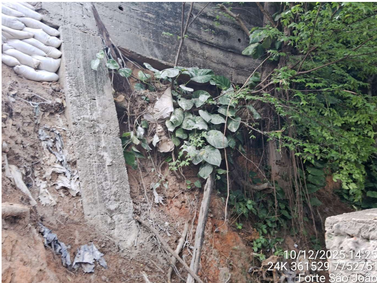
Imagem 04 – processos erosivos instalados na crista do talude, em contato com muro de contenção.
