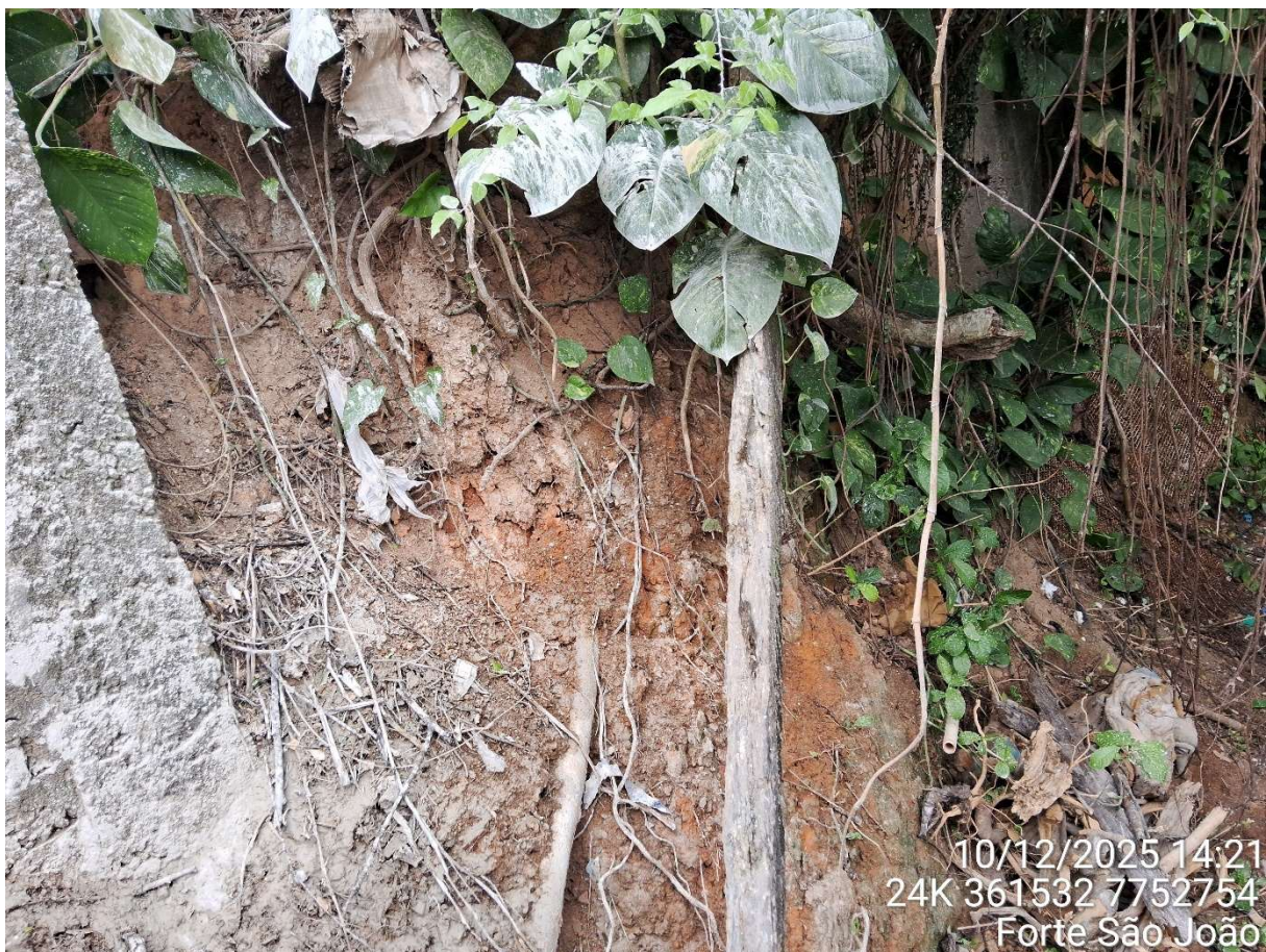
Imagem 03 – Processos erosivos instalados no talude.
