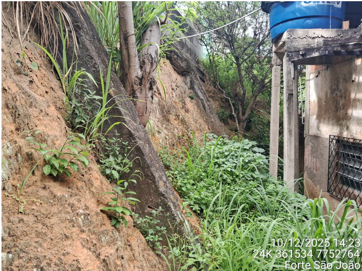
Imagem 02 – talude localizado nos fundos do imóvel do Sr. João do Carmo Farias.
