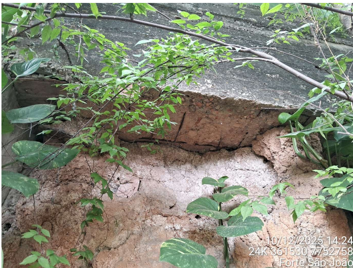
Imagem 05 – processos erosivos no contato com a base do muro de contenção, localizado a montante do imóvel do Sr. João.
