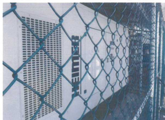
GERADOR DE ENERGIA
