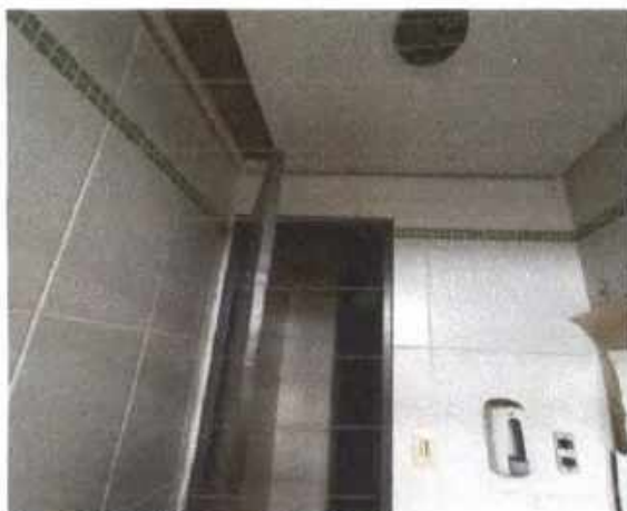
Figura 66 – Banheiro em funcionamento
