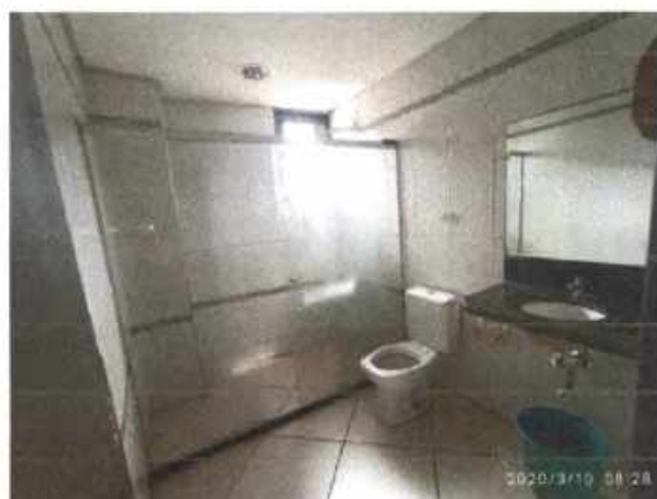
Figura 65 – Banheiro em funcionamento
